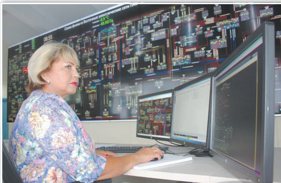
Центр управления сетями ВЭС.
